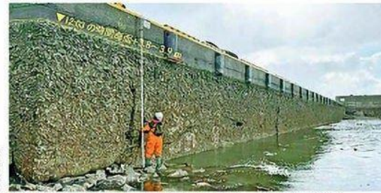
約4mの隆起が確認された輪島市門前町鹿嶋(かいそ)漁港の防潮堤の様子(産業技術総合研究所地質総合センター提供)
