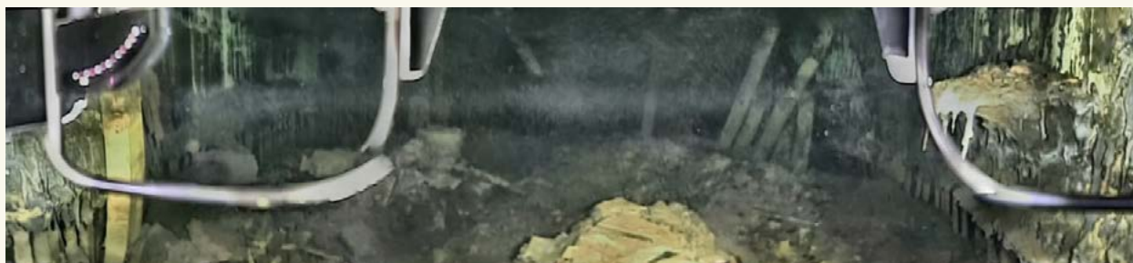
溶け落ちた核燃料の熱で鉄筋むき出しとなった1号機圧力容器の土台＝ IRID 提供
