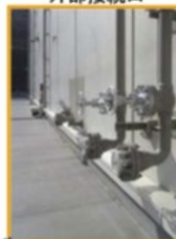
代替注水配管 外部接続口
