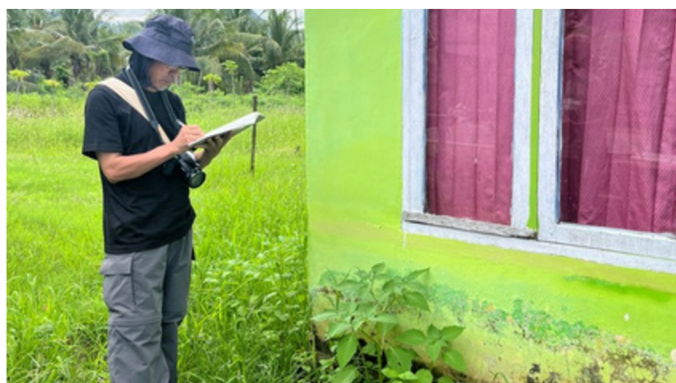
インドネシア・ゴロンタロ州で起こった洪水にて浸水した家 窓枠のすぐ下まで水がきたことがわかる
